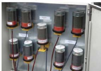
Trattamento rifiuti alimentari: cabina di Memolub per la lubrificazione dei cuscinetti dei trasportatori di un fermentatore rotativo.
